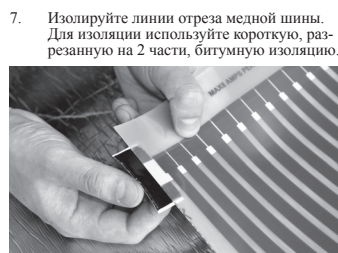
Рис. 5. Пример правильной установки изоляции линии отреза медной шины
